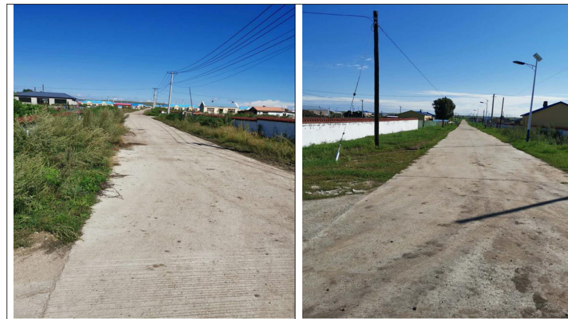
罕达盖嘎查街区排水现状
